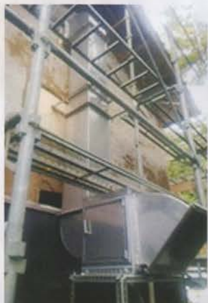
▲護摩の煙抜き用のダクトです。まるで焼肉屋です(笑)
